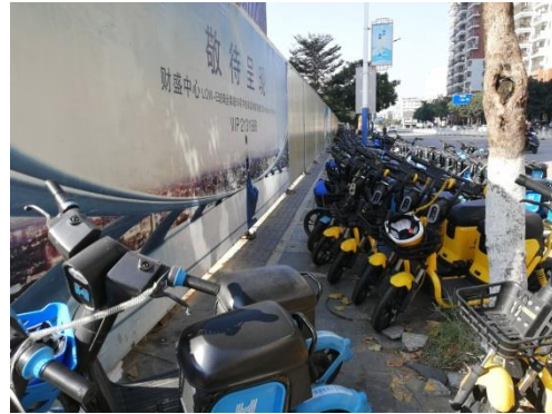
圖 6 施工建設圍欄建在盲道周邊
