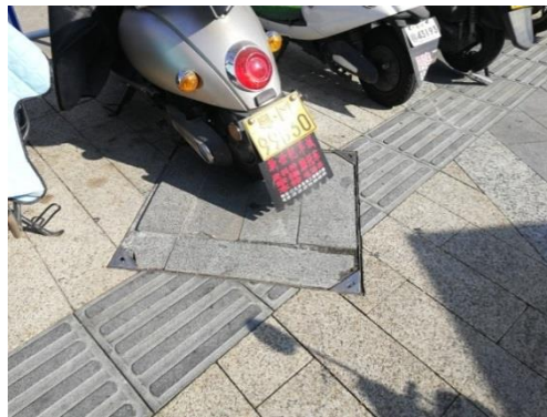
圖 7 盲道中斷，且被佔用
