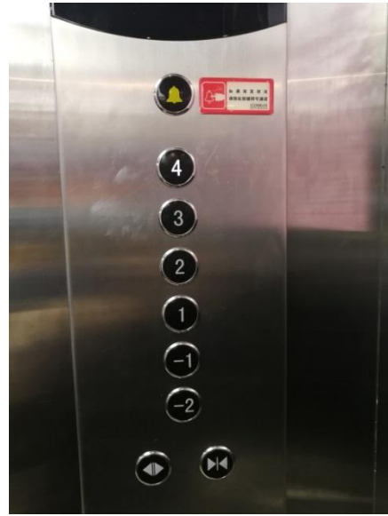
圖 24 無障礙電梯側邊設置選層裝置
