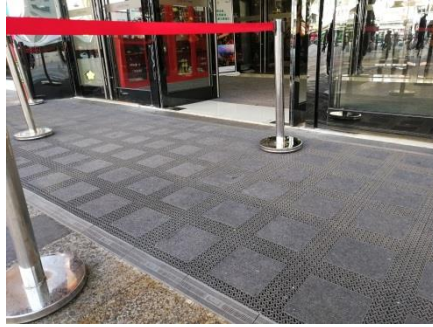
圖 2 廣場出入口濾水圓孔洞寬度過大
