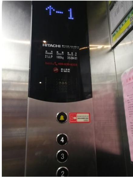
圖 23 無障礙電梯側邊設置報警裝置
