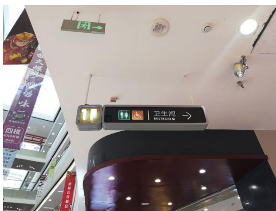
圖 41 無障礙廁所處設置無障礙標誌
