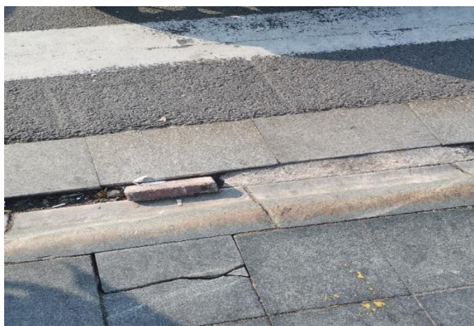
圖 3 緣石坡道障礙
