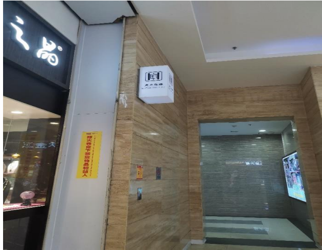
圖 8 電梯缺乏無障礙標誌
